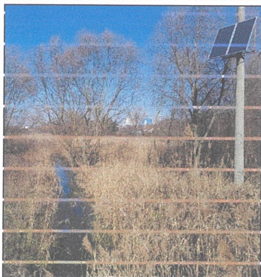
Obr. 6. Solární panel na sloupu.
